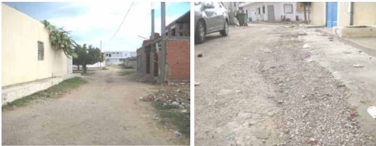
Etat dégradé de quelques voiries du quartier
