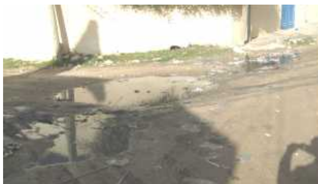
Rejet direct dans la rue
