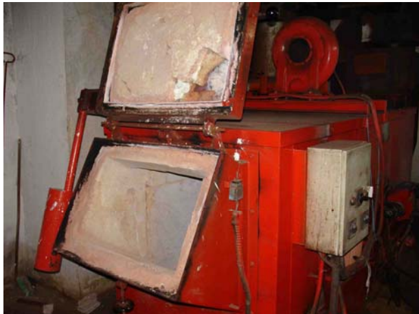
Mauvais état des réfractaires de l'incinérateur de
