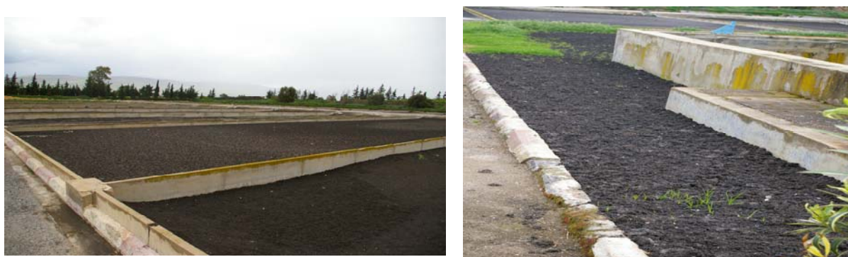
Figure 7-3 Lits de séchage et de stockage des boues, STEP Jendouba
